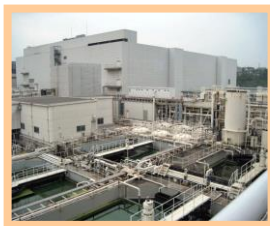
排水処理設備
